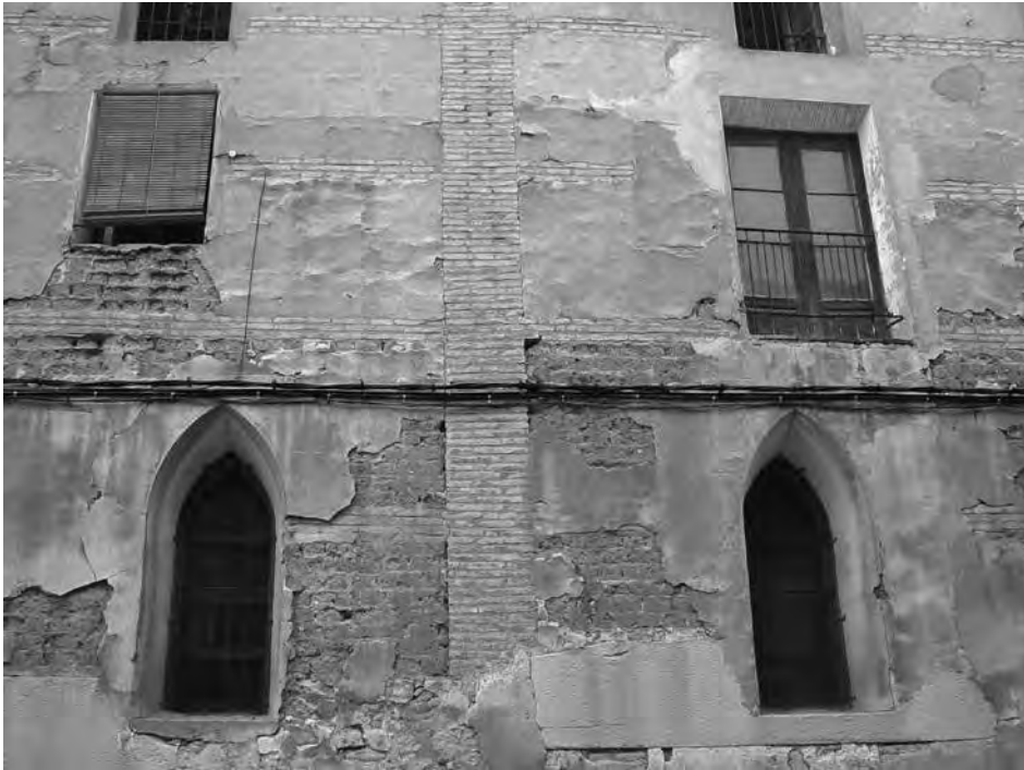
"Casa de la Bilbaína". Detalle constructivo de columnas y calles de ladrillo macizo, rellenando los paños con adobe, todo lucido con yeso.
